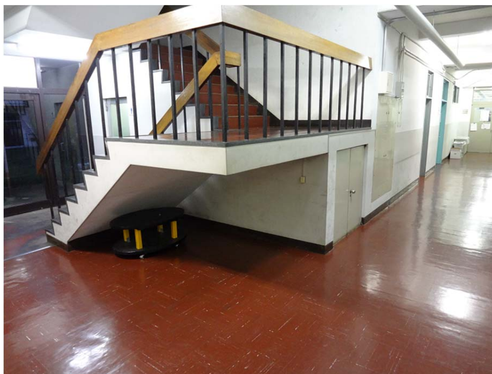
図 7.1 白杖の死角となる階段（工学院大学犬目第 2 校舎 1 階）
